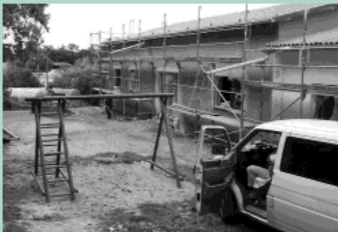
Baufortschritt der Kindertagesstätte in Nieschütz – die Dacharbeiten sind beendet und der Innenausbau schreitet voran
